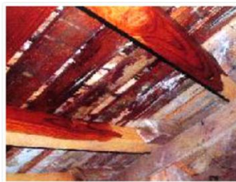
不良工事での雨漏れ
