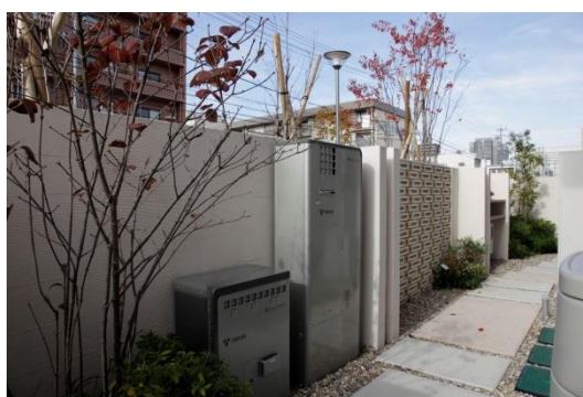
▲ガスで発電・給湯するエネファーム
