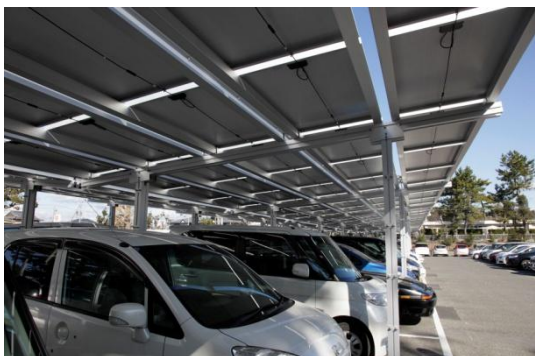
▲駐車場の屋根に太陽光が取り付けられている
