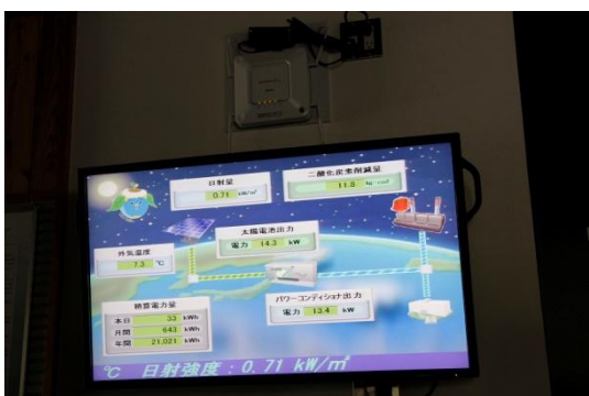
▲校舎内の発電量モニタ
